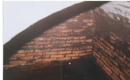
Regenwaterkelder in het huis van Jannie Slotboom
